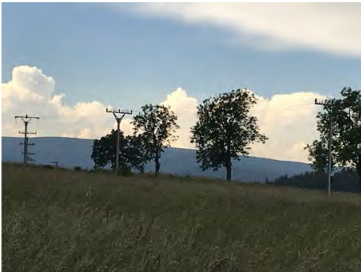
Obr. 46 - Vedení VN na horizontu Václavova u Bruntálu
